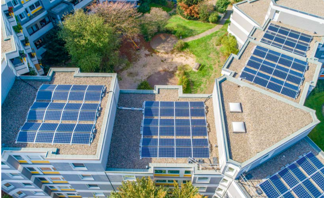
Mieterstromprojekt von Solarimo in Duisburg. © Solarimo
