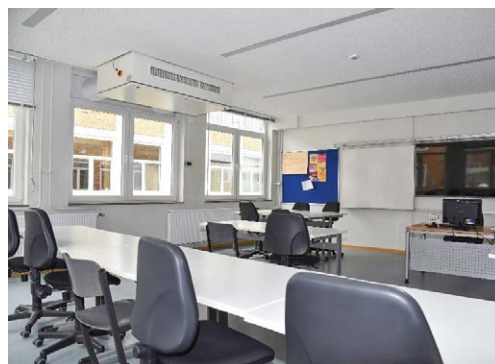
Das Lüftungsgerät VRL-C von Stiebel Eltron sorgt für permanent gute Luft im Klassenraum, senkt die Aerosolkonzentration und gewinnt die Wärmeenergie aus der Abluft zurück. © Stiebel Eltron
