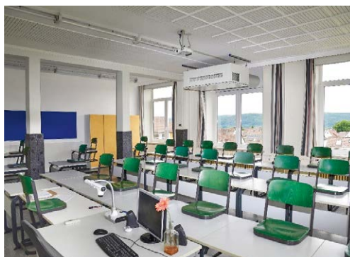
Lüftungsgeräte senken die Aerosolkonzentration in geschlossenen Räumen, wie hier in einem Klassenraum der Georg-von-Lagen-Schule in Holzminden. © Stiebel Eltron
