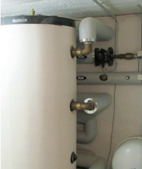
Geräuscharme Wärmepumpen zur Beheizung der 6 Wohnhäuser
