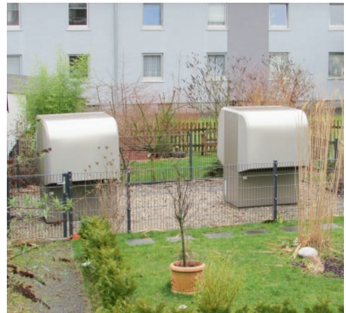
Sparsame Aufstellung der Pufferspeicher im mittleren Gebäude
